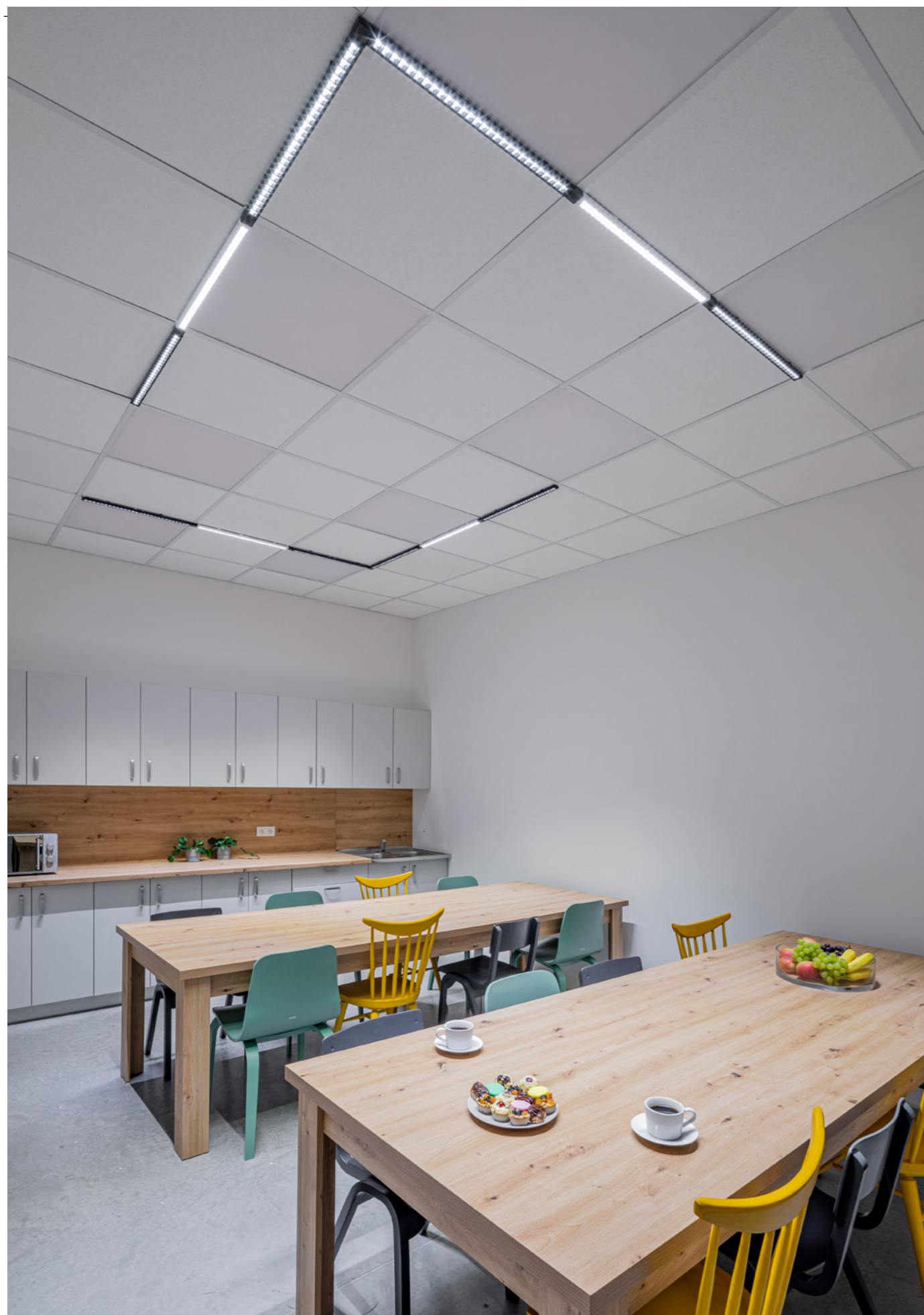
Zastosowanie systemu Terrano w kuchni biurowca
